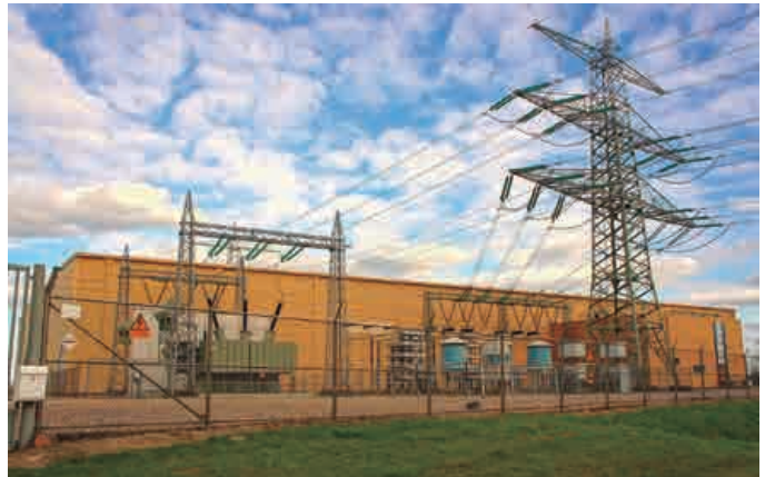
Figura 3. Subestación de transformación eléctrica
