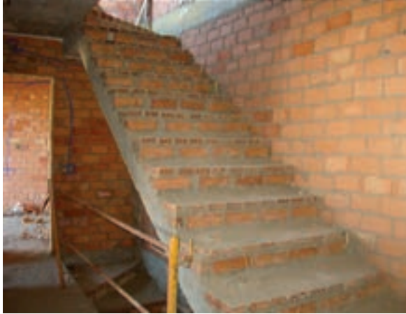
Figura 1. Peldañado de la escalera con ladrillos y mortero
