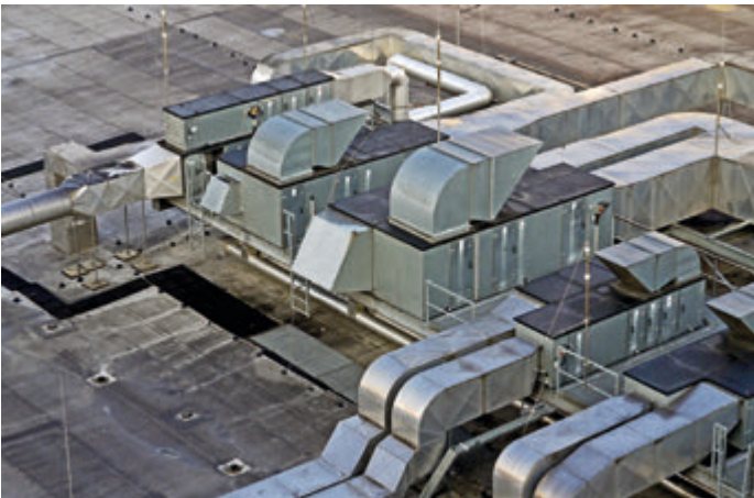
Figura 2. Climatizadores (unidades de tratamiento de aire) instalados en la cubierta del edificio
