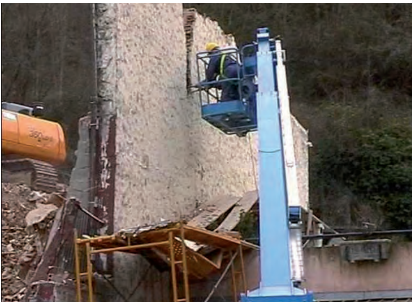
Figura 7. Corte vertical del muro mediante medios manuales para su posterior demolición por empuje o tracción. Fuente: GESPRE, S.L.
