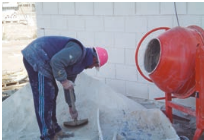
Figura 1. Elaboración de un mortero en el tajo mediante dosificación manual y mezclado y amasado mecánicos.
