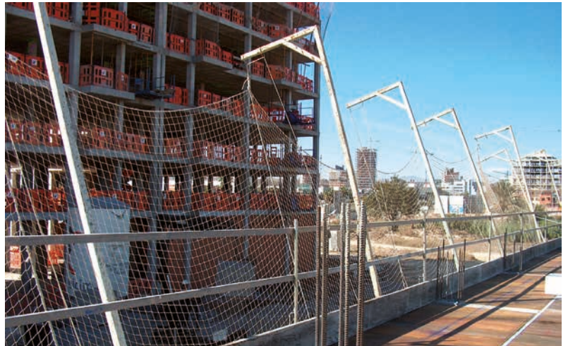
Figura 6. Red de seguridad sujeta a soportes tipo horca
