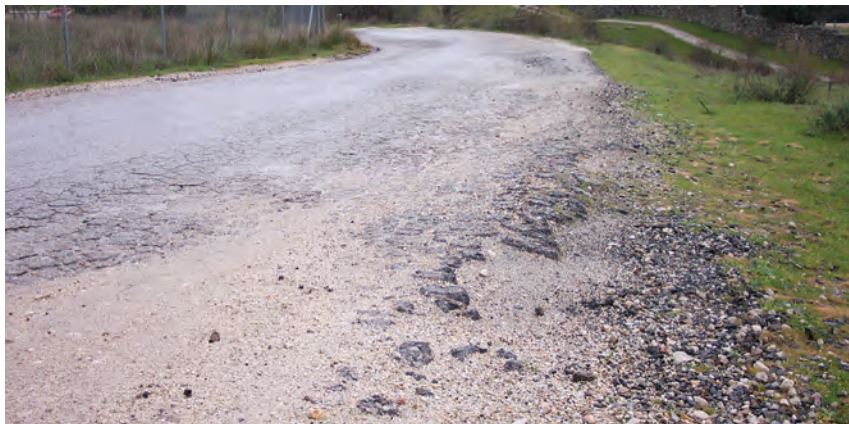
Figura 3 (a). Firme con regularidad insuficiente
