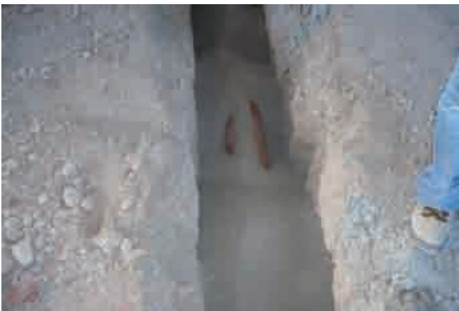
Figura 5. Línea eléctrica enterrada en una parcela
