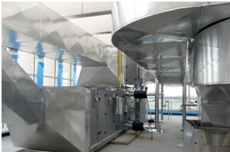
Figura 1. Instalaciones de climatización. Grupo Ortiz. Fuente: Fundación Laboral de la Construcción
