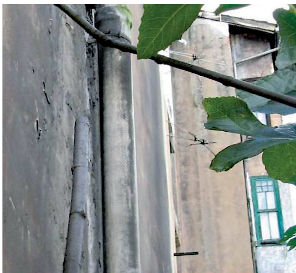
Figura 10. Bajante de fibrocemento. Fuente: IGR, S.A.
